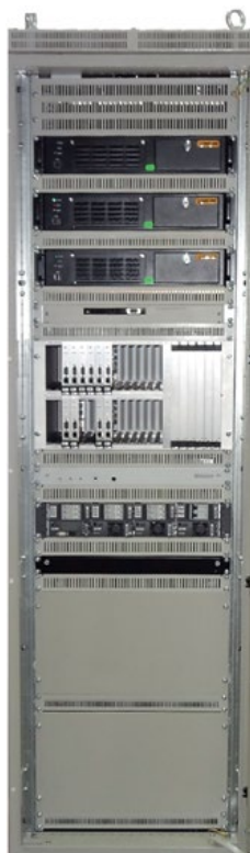
Коммутационная станция «МиниКом - КСР»
